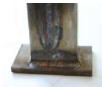
1. Inox : cordon de soudures avec dépôts d'oxydes
